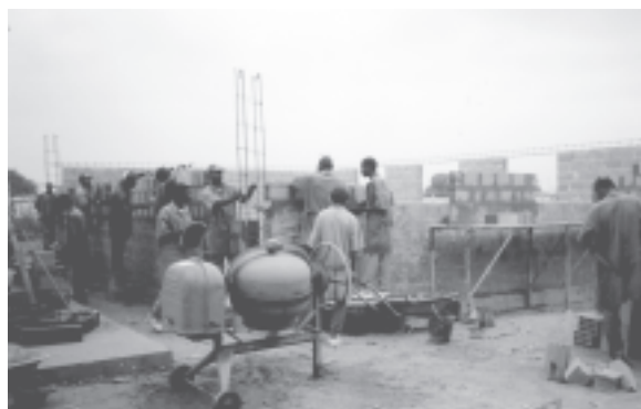
Formandos de Construção Civil colaboram na reabilitação das instalações do centro de formação durante a formação em exercício
